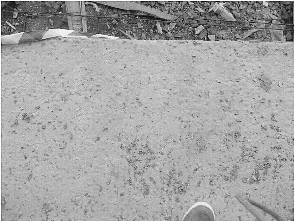
Фото 10. Трещины в плите перекрытия.
