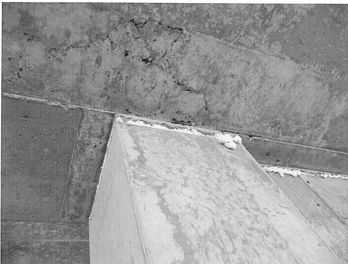
Фото 13. Участок непровибрированного бетона в плите перекрытия.
