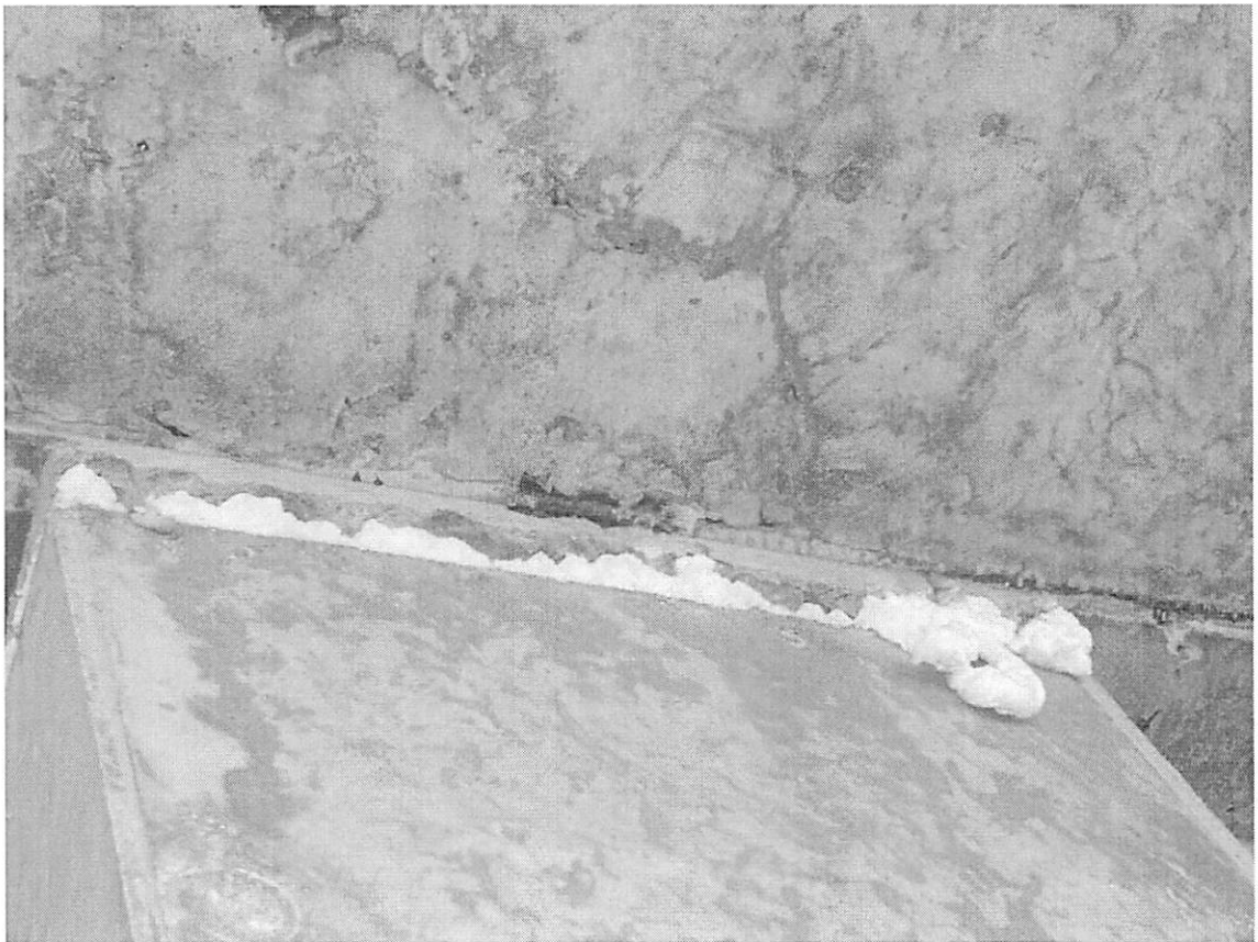
Фото 12. Участок непровибрированного бетона в плите перекрытия.
