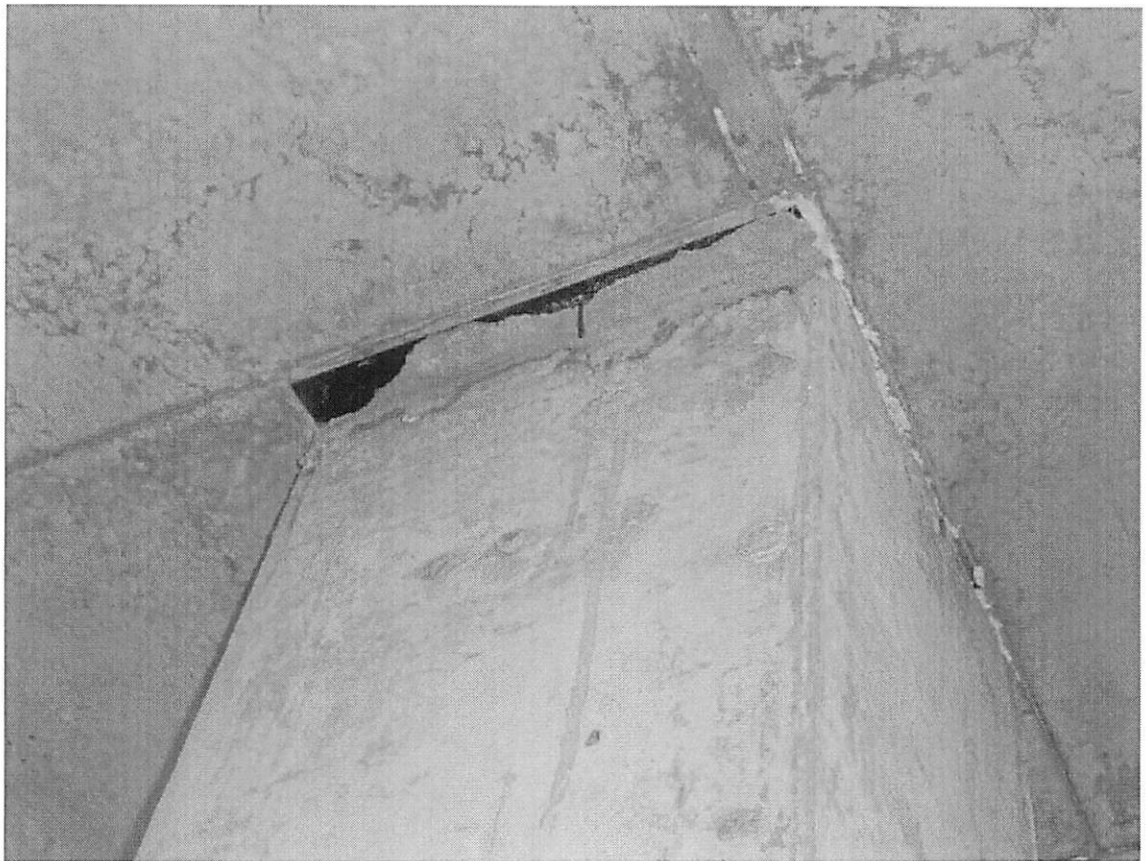
Фото 7. Непровибрированный бетон в верхней зоне колонны.
