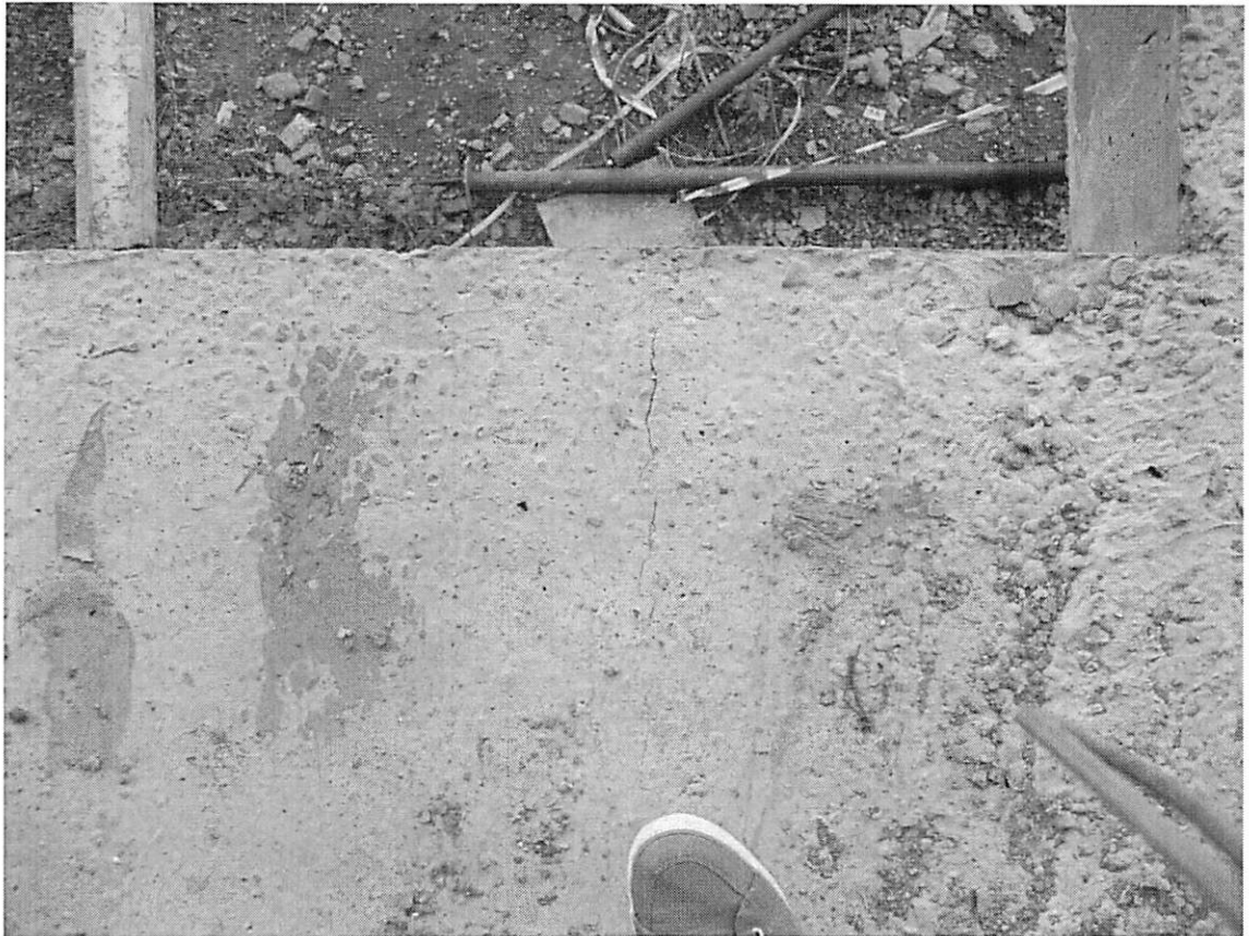
Фото 11. Трещины в плите перекрытия.
